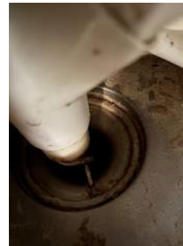
Baderomssluk plassert tilgjengelig bak inspeksjonssluke under badekaret.
