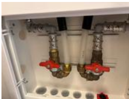
Hovedstoppekran for kaldt og varmtvann plassert i eget skap i bod.
