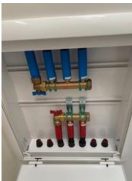
Rørfordelerskap plassert i himling på badetrom.
