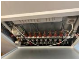
Fordelerskap med kursfortegnelse for vannbårenvarme, plassert i bod.
