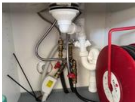
Avløpsrør i underskap vask på kjøkkenet.
