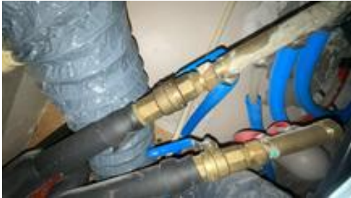
Stoppekraner stenger vanntilførselen 100%.
