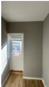
Ingen ventilasjon i dette rommet.
