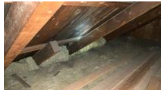
Skråtak er etterisolert mot taktro/bordtak. Det er ikke etablert lufting mellom disse sjiktene, som er en anbefalt løsning for slike skråtak.
