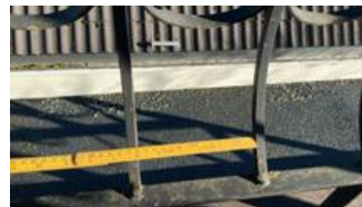
Åpninger i rekkverk er større enn 10 cm.
