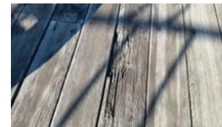
Gulvbord med råteskade,
