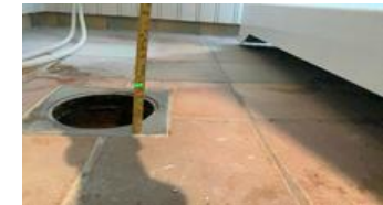
Det er fall mot sluk, men fallforhold er ikke iht. dagens forskriftkrav.
