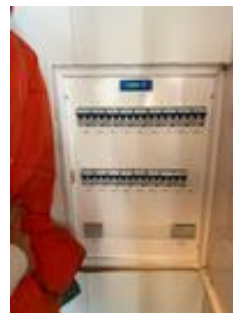
Sikringskap plassert i entre/ gang.
