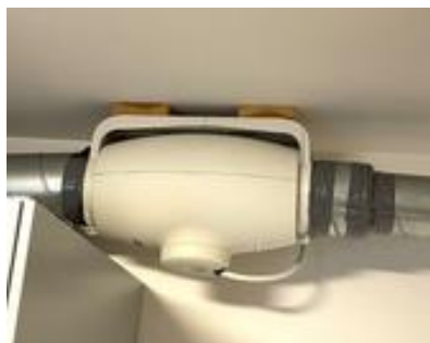
Avtrekksmotor på vaskerom
