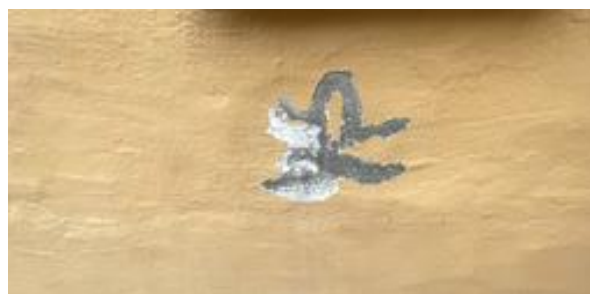
Eksempel på avskalling
