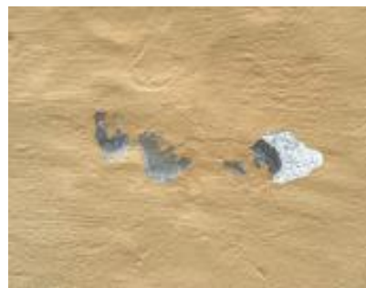
Eksempel på avskalling
