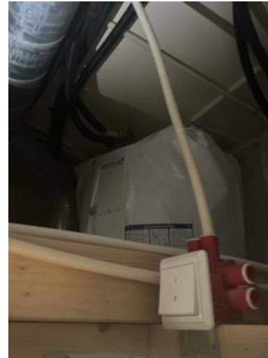
VVB over inspeksjonsluke på bad.
