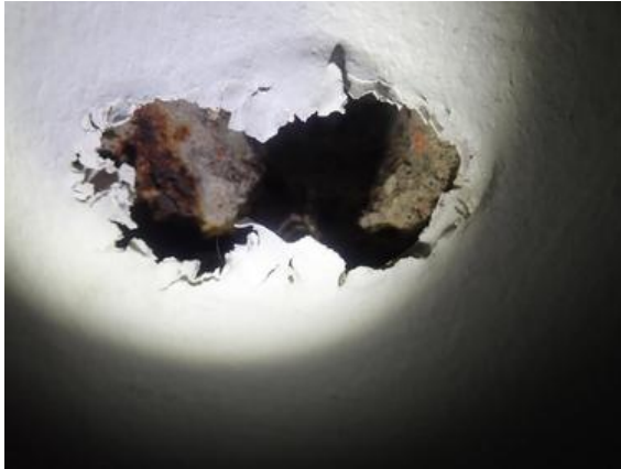
Foto 1: P1, 505, soverom, ved vindu, i skade.
