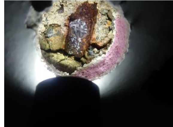
Foto 11: P12, 511. Det er registrert klorider i betongen.
