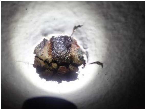
Foto 6: P5, 509, i skade.
