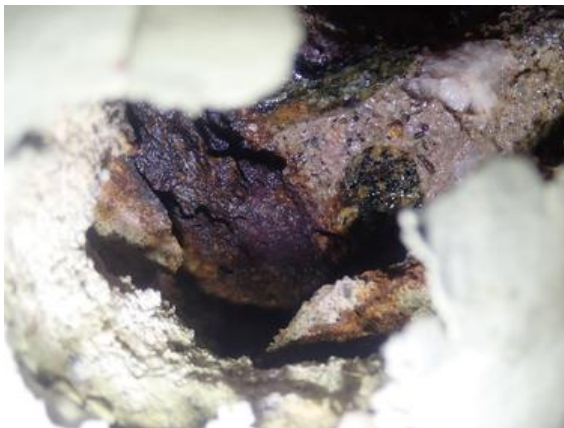
Foto 2: P2, 505, stue, ved vindu, i skade.
