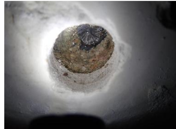
Foto 12: P13, 608, i lekkasjested.
