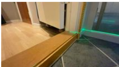
Høydeforskjell (flis ved terskel)
