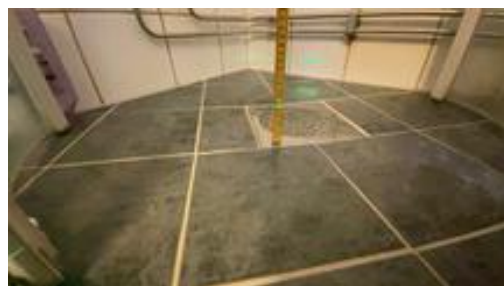
Høydeforskjell (ved sluk)
