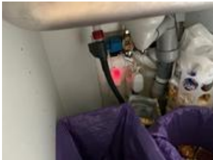
Magnetventil og sensor i skap under vask.
