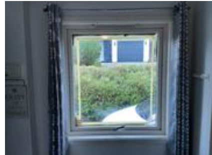
Vinduer fra byggeår har passert mer enn 50% av forventet levetid.
