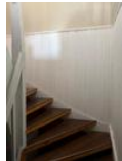
Trapp mellom etasjene er av tre. Det er ikke montert håndløper på vegg i trappeløp.
