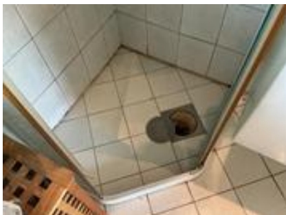
Sluk i gulv er fra byggeår.
