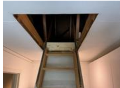
Nedtrekkbar loftstrapp for tilkomst til koffertloft/ kaldloft.
