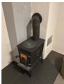
Støpejernsovn på treningsrommet i kjeller
