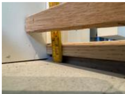
Oppkant ved dør er under 15mm.
