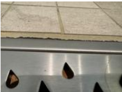
Sprekk ved slukrist.
